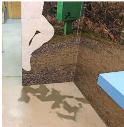
Aufgrund der Flecken am Boden wurden die Betreiber des Zentrums auf den Wasserschaden aufmerksam. Foto: PD / Nathalie Guinand
